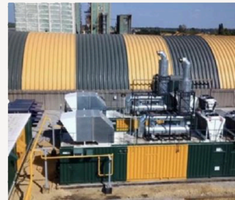
Энергоцентр для поставщика зерна Тамбовская область Электрическая мощность 2,76 МВт
