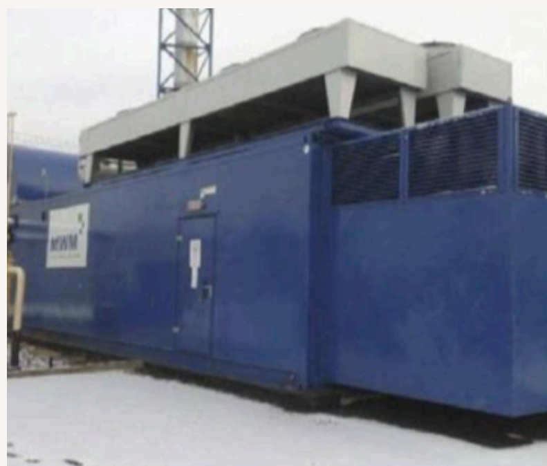
Энергокомплекс для молочного комбината ООО «Энергоаудит-Консалтинг», г.Пенза Электрическая мощность 2,0 МВт
