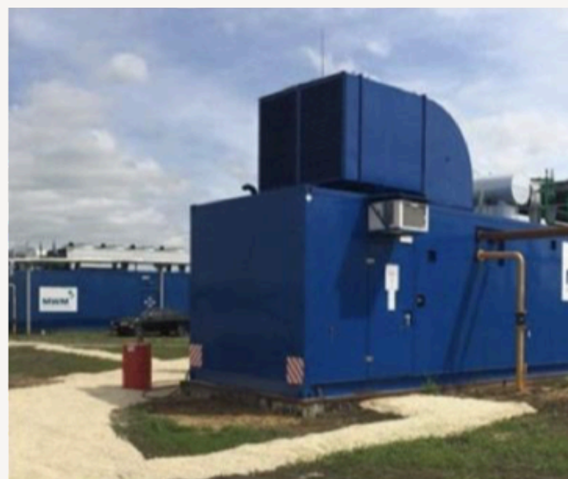
Энергокомплекс для завода по переработке мяса птицы ООО «Энергоаудит-Консалтинг», г.Пенза Электрическая мощность 12,0 МВт
