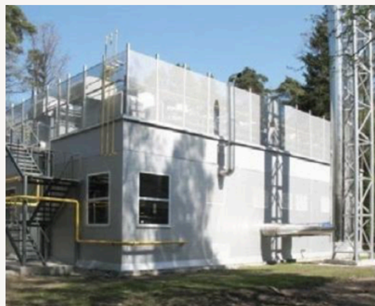
Энергоцентр на крыше здания г. Зеленогорск Электрическая мощность 1,5 МВт
