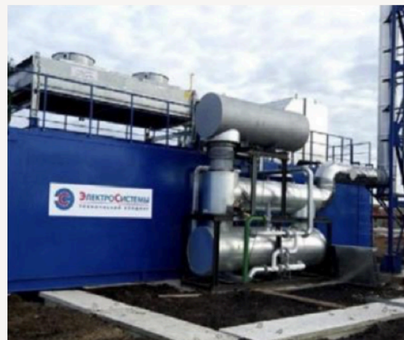
Энергокомплекс для мясоперерабатывающего комплекса ООО «Энергоаудит-Консалтинг», Мордовия Электрическая мощность 4,0 МВт
