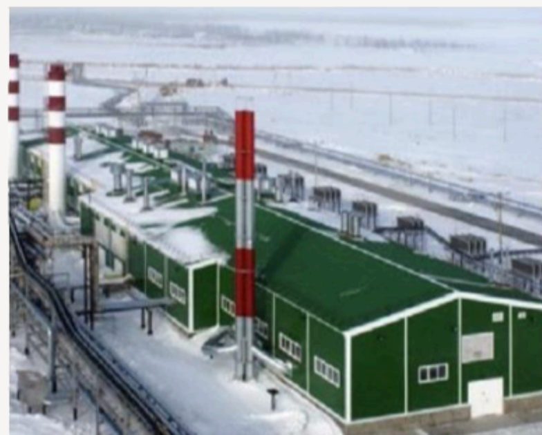
Энергоцентр для Самбургского нефтегазоконденсатного месторождения ОАО «Артикагаз», Ямало-Ненецкий АО Электрическая мощность 24,5 МВт
