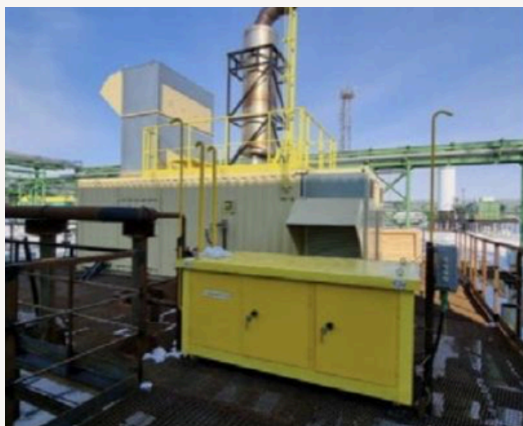
Энергоцентр на месторождении ООО «СК Русвѣтпетро», НАО Электрическая мощность 0,8 МВт
