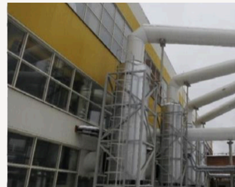
Энергоцентр для НИЦЭВТ г.Москва Электрическая мощность 17,2 МВт
