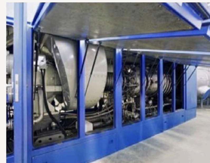
Энергоцентр для технопарка «Технопарк», г. Ногинск Электрическая мощность 32 МВт
