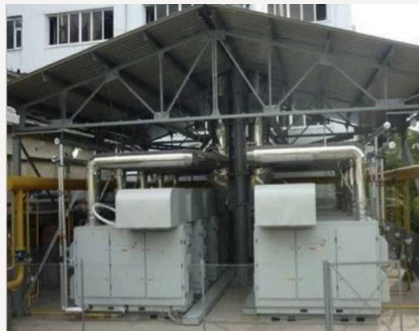
Энергоцентр для санатория г.Сочи Электрическая мощность 1,0 МВт
